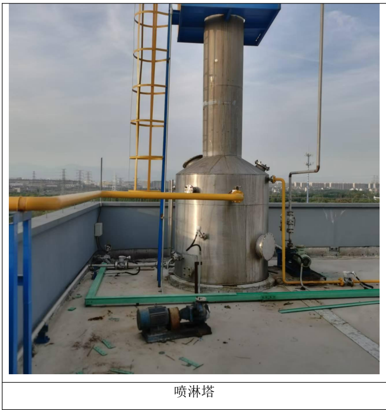
图 4-3 废气处理装置
